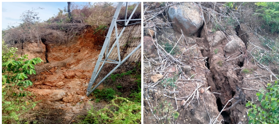
Gambar 1. Kondisi Eksisting Lereng Pada Lokasi Tower T-97 Sumber : Dokumentasi Pribadi
